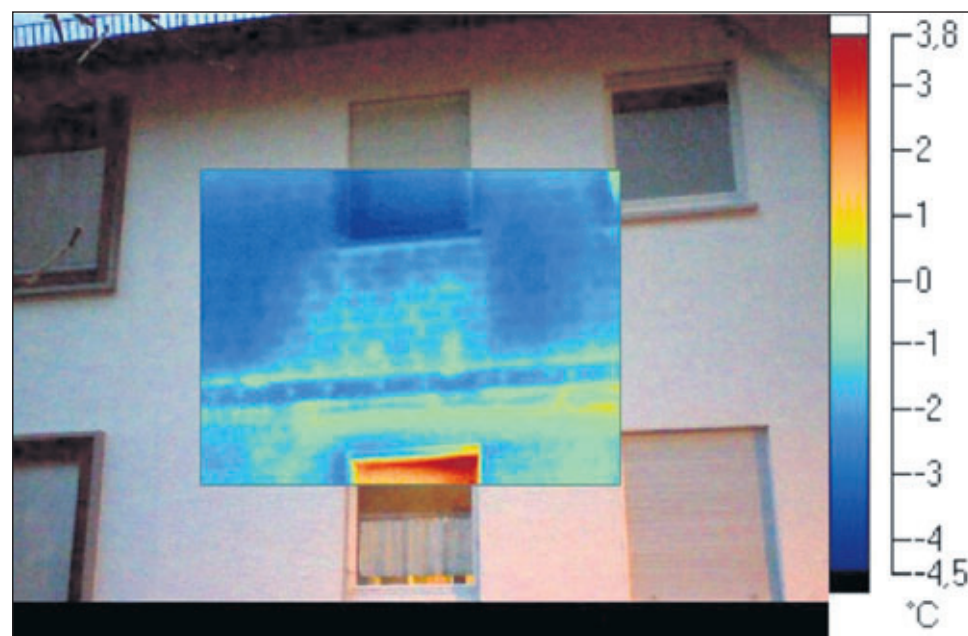
Eingeblöckt ist das Thermo-Foto: Das Fenster mit geschlossenem Rollläden lässt wenig Wärme raus.
